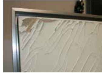
Schade detail craquelé
